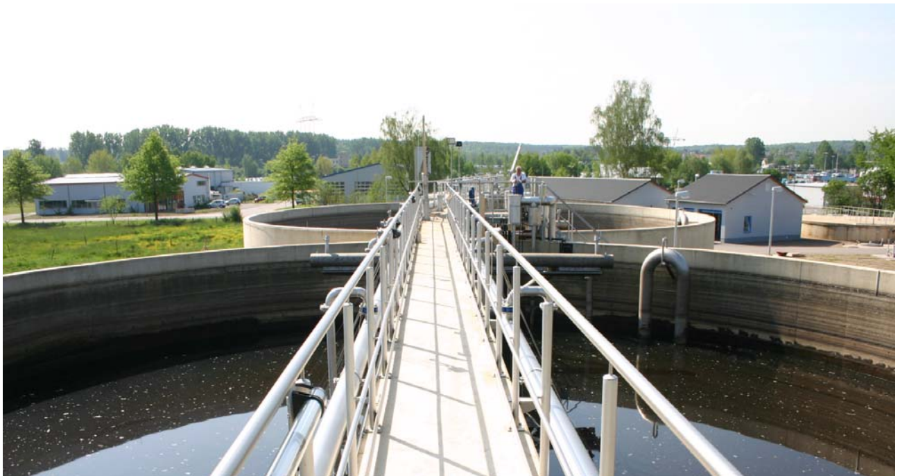
Zwei von insgesamt drei SBR-Becken der Kläranlage Überherrn
