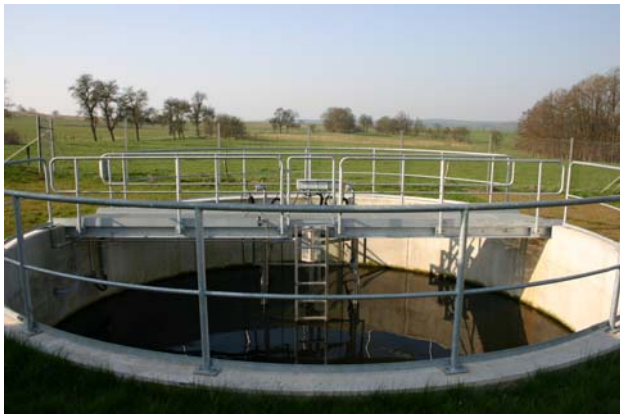
Mehrzweckbecken der Kläranlage Utweiler
