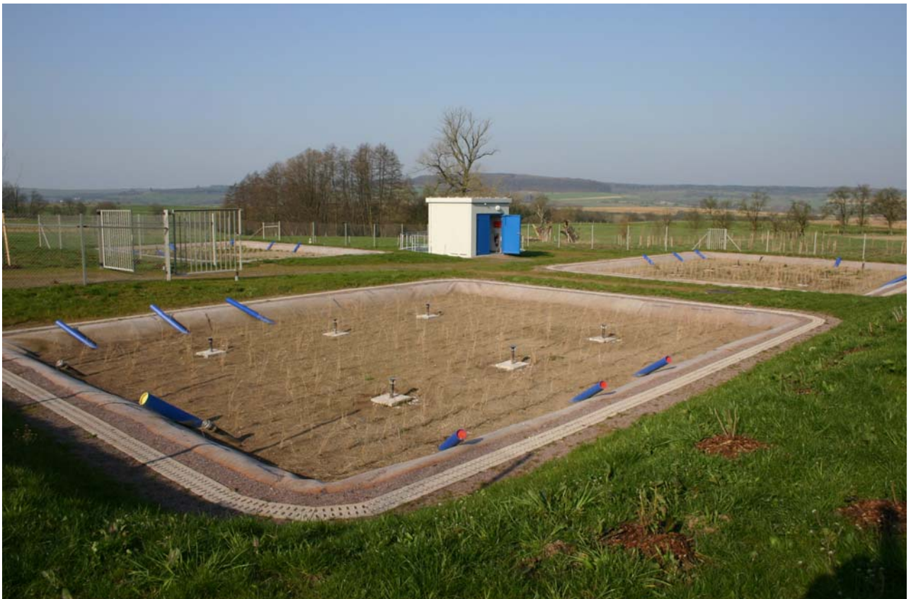
Gesamtansicht der Kläranlage Utweiler - belüfteter Vorteich (hinter dem Betriebsgebäude) und Pflanzenbeete
