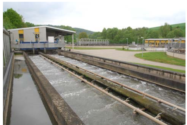
Im belüfteten Sandfang werden Sand, Kies und Fette entfernt.
