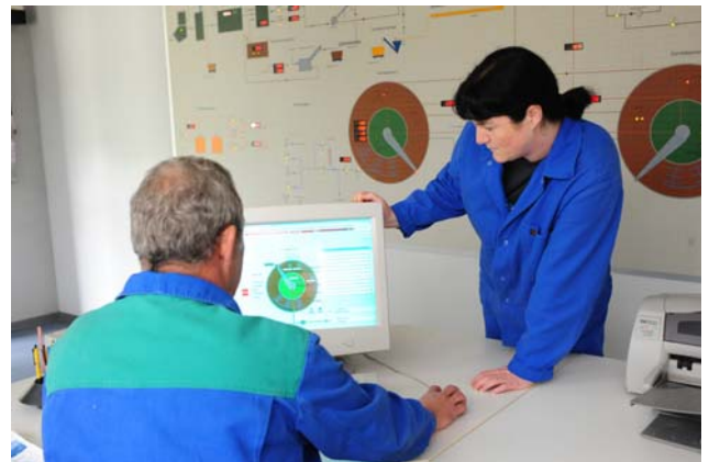
In der Leitwarte der Kläranlage Wustweiler
