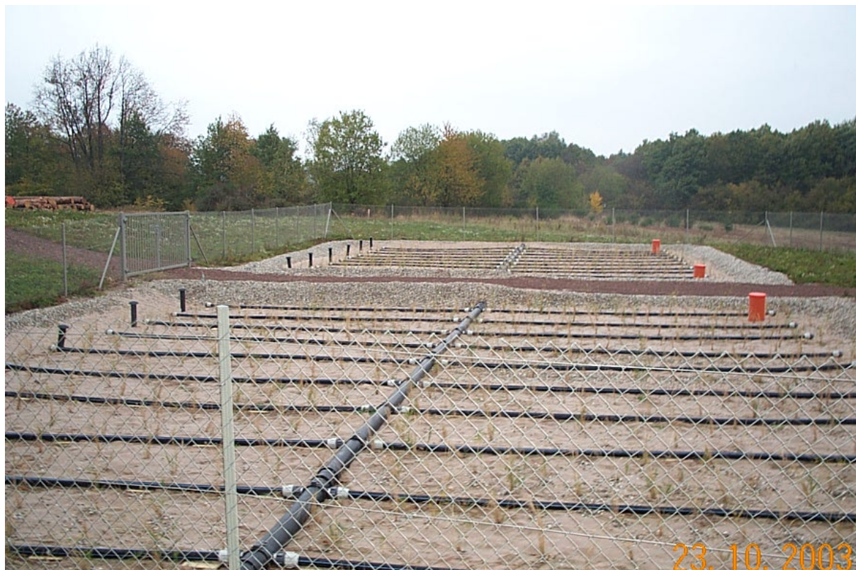
Abbildung 4: Pflanzenbeete der Kläranlage Vogelsbüsch
