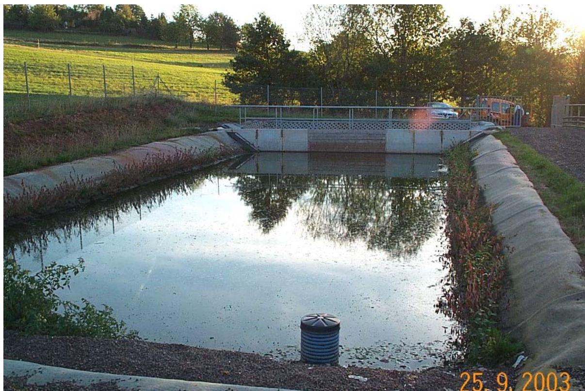
Abbildung 1: Absetzteich der Kläranlage Reidelbach
